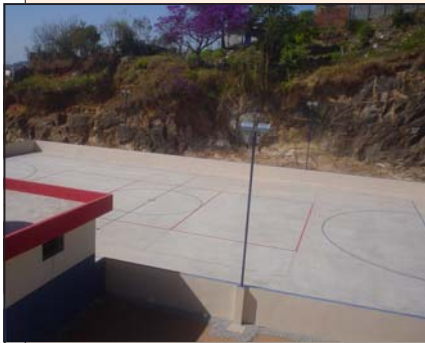
Quadra poliesportiva do bairro Nossa Senhora Aparecida já entrou em fase de acabamento.
