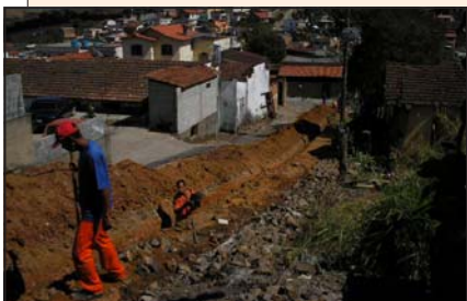
Construção de uma rede de esgoto na Avenida do Contorno, no bairro Bom Pastor.
