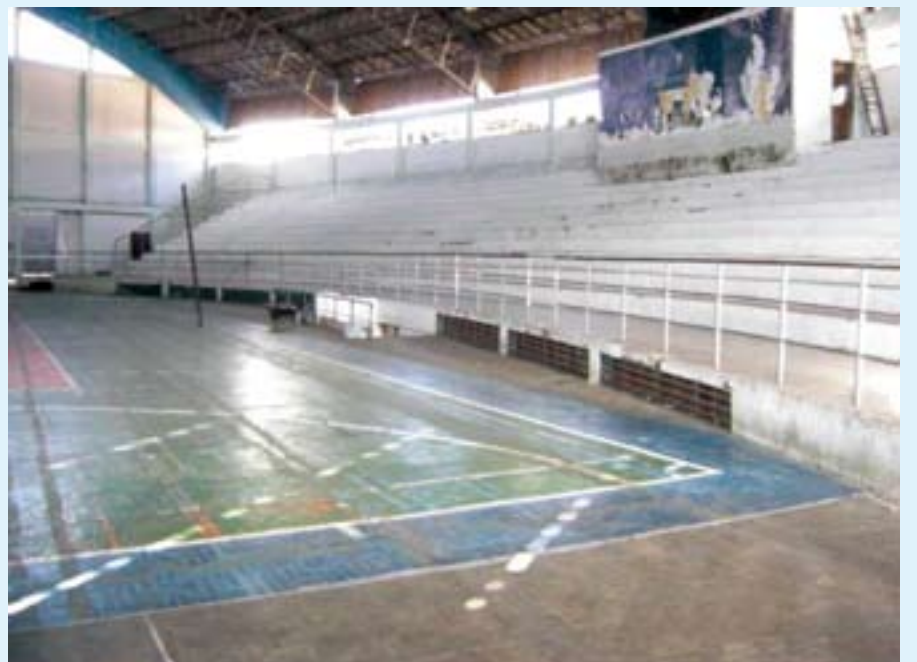
O piso da quadra está solto e degradado e o telhado em péssimo estado
