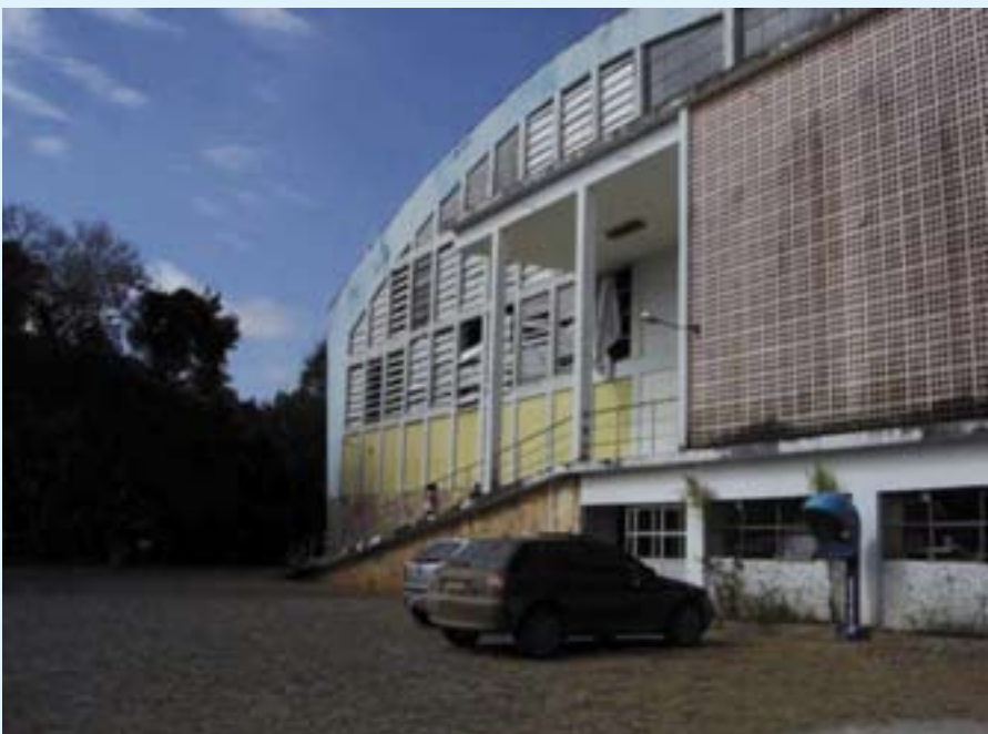
A fachada do Sílvio Raso está em condições precárias
