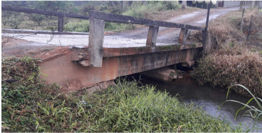
FOTO 01 Ponte danificada que existia no local
