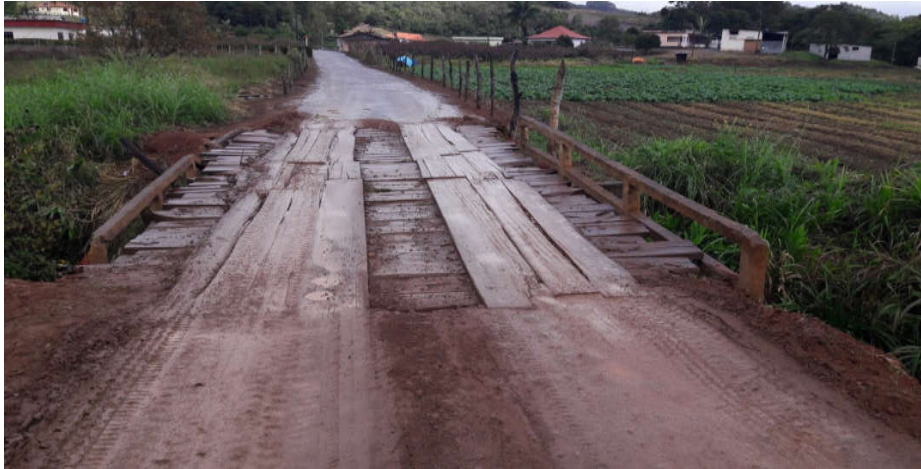
FOTO 01 Ponte danificada que existia no local
